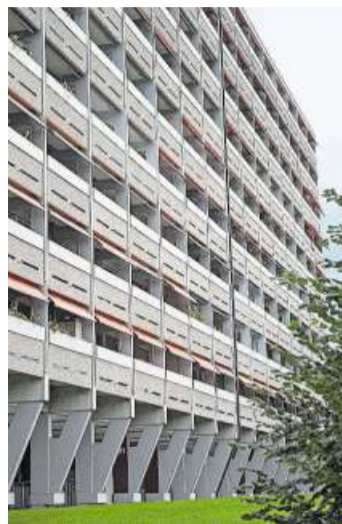
Die Scheibenhäuser sind in schlechtem Bauzustand. Bild: Maria Schmid
